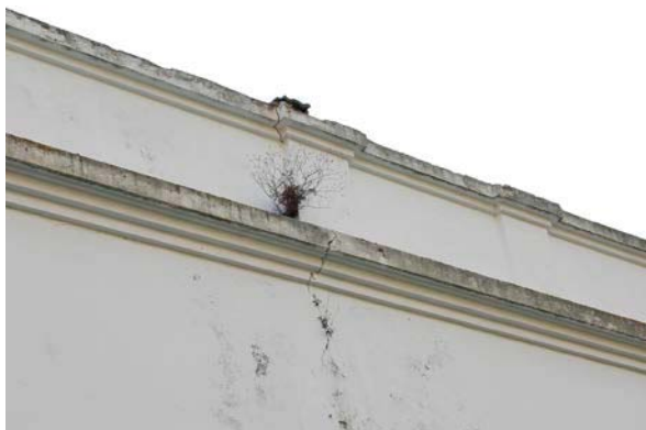
Figura 6: Grieta estructural y agentes bióticos.
